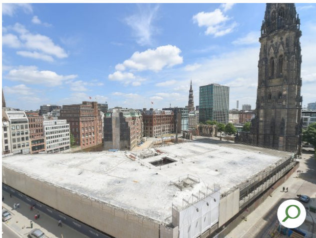
Eine Betonwüste mitten in der Innenstadt: Die Commerz Real hat das Gebäude bis zur ersten Etage abgerissen – seither passiert nichts. Foto: Klaus Bodig / HA
